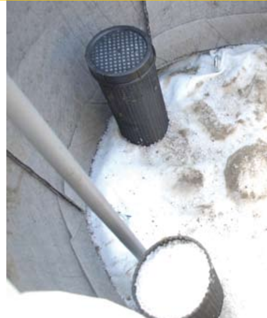
Capillaire kokers gevuld met broadleaf voor de regulering van water in een grote bomenbak.
